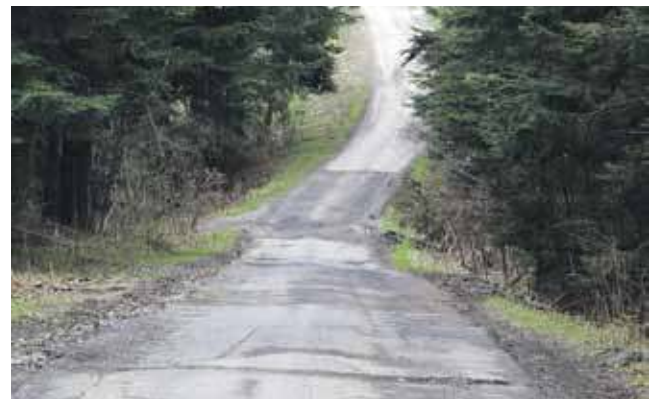
Największe dziury pozostały na najbardziej stromych odcinkach drogi.
