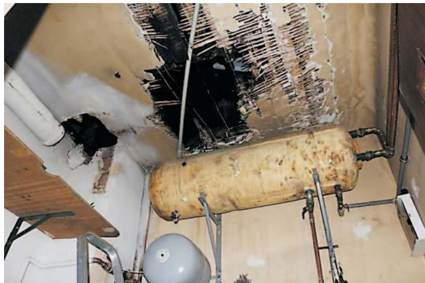
W wyniku pożaru, który objął część dachu i powalę, zniszczone zostały: kuchnia, łazienka, kotłownia i jeden z pokoi
