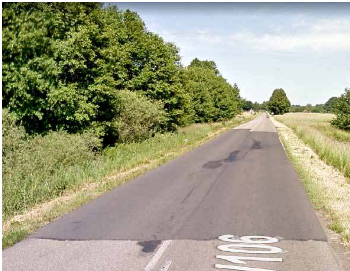
Temat uskoku przed Ogorzelami ciągnie się od lat. Zadowalającego efektu brak
