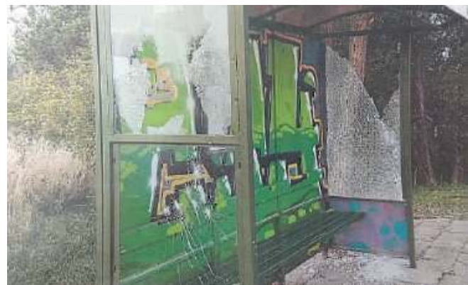
Wandale zdewastowali wiatę za pomocą młotka bezpieczeństwa
