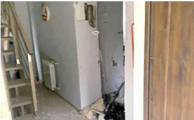
Uszkodzenia były znaczące
