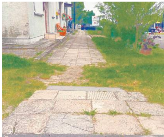
Na chodnikach często dochodzi do potknięć i upadków.
