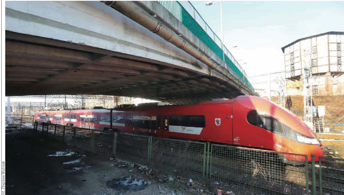
W czerwcu dowiemy się, w jakim naprawdę stanie jest ten wiadukt
