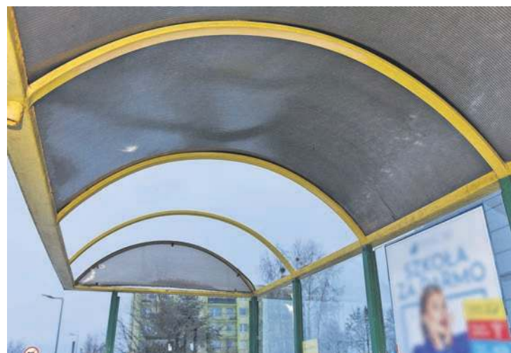
Przystanki autobusowe w mieście wymagają naprawy lub powinny być wymienione. Od wielu tygodni ten przy ul. Leśnej nie ma części dachu.
