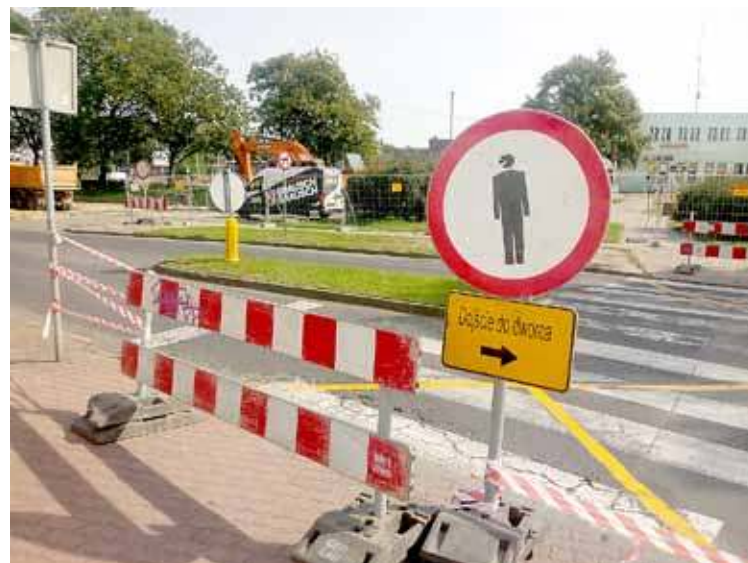
Zamknięte przejście dla pieszych przy ulicy Kazimierza Puławskiego
