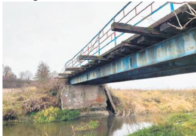
Zdaniem fachowców naprawa mostu będzie kosztowała ok. 1 mln zł. Mieszkańcy Mikulina uważają, że to przesada.
