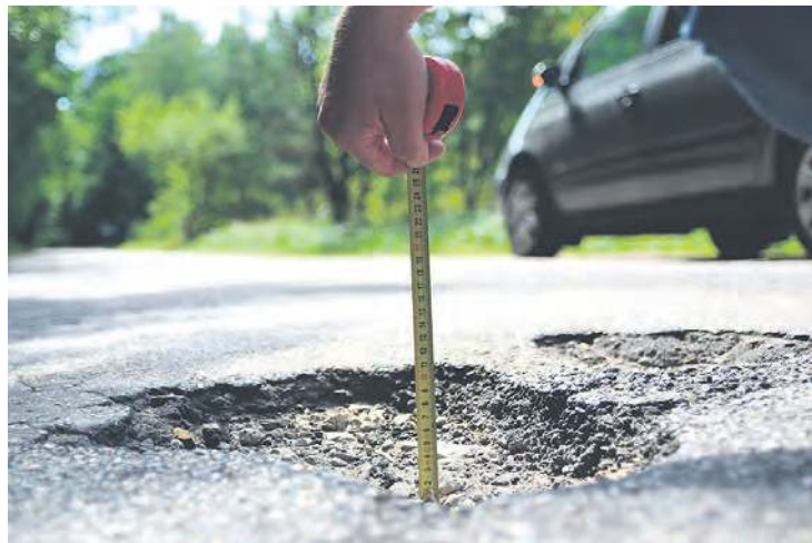
Droga wymaga remontu. Uzupełnianie ubytków nie wystarcza, mieszkańcy apelują o zrobienie nowej nawierzchni.
