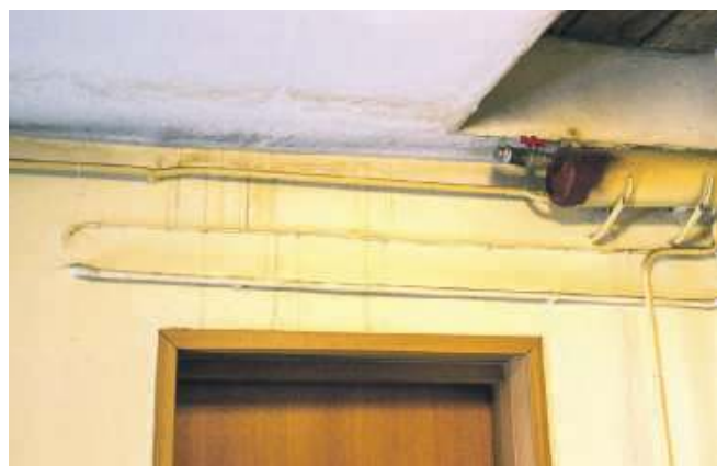
Klatki schodowe i mieszkania notorycznie są zalewane
