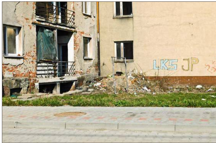
Śmieci wciąż zalegają wokół budynku. Tu akurat zmieszane z ziemią.
