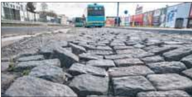
Kostka w części zatok jest w fatalnym stanie
