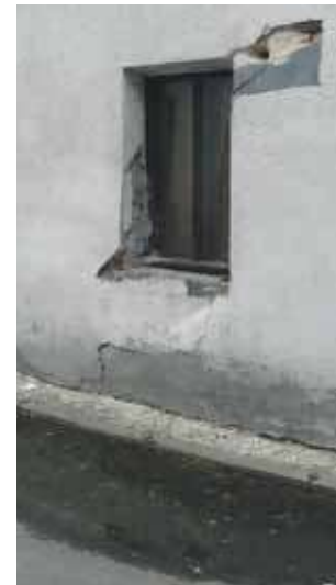
Przez zapadlisko na miejskiej drodze uszkodzony jest prywatny budynek, w którym działa restauracja
