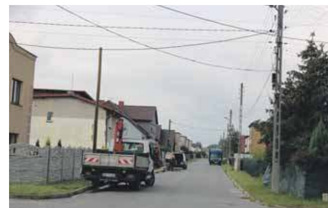
Las słupów i kabli na ul. Sempołowskiej w Tarnowskich Górach. Mieszkańcy się zbuntowali
