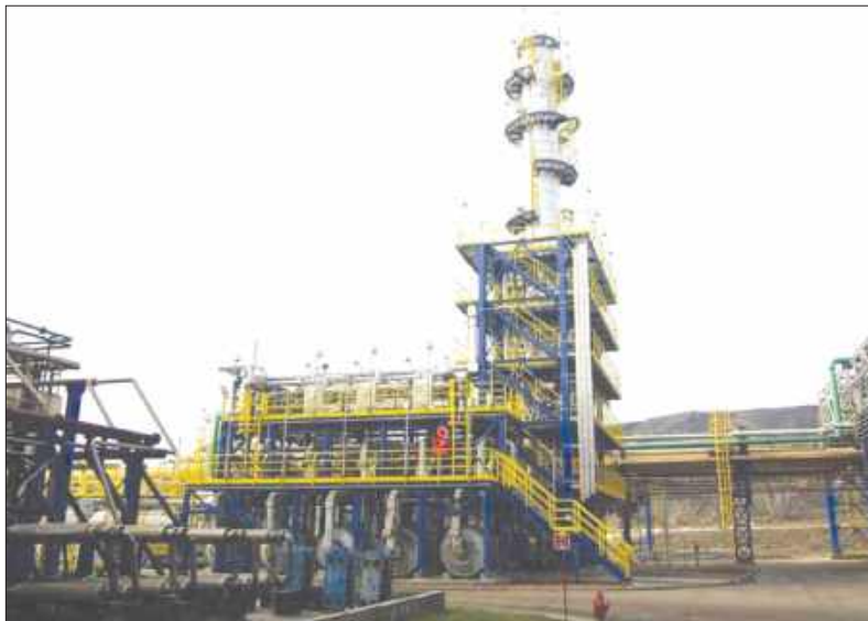
■ Instalacje JSW Koks w Radlinie, zdjęcie ilustracyjne FOTO: JSW KOKS
