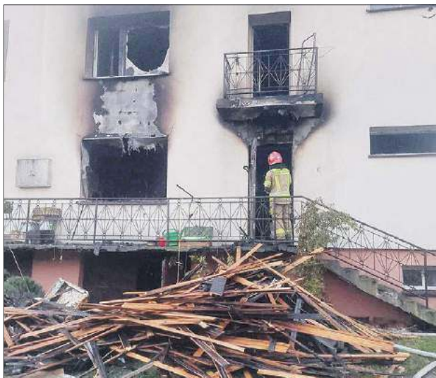
Barbara Prudaczka to emerytowana nauczycielka z Wisznice. Jej dom został zniszczony przez pożar. Zbiórka ma na celu zebranie środków na jego odbudowę
