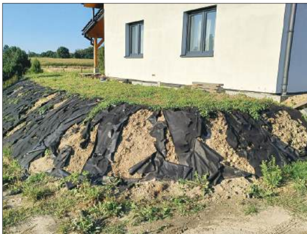
■ Uszkodzenie agrowłókniny – efekt działalności saren
