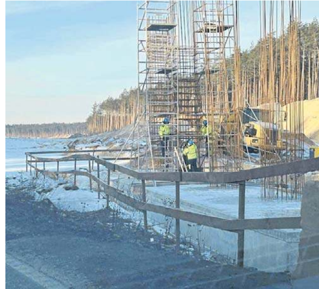
Dużo dzieje się na budowie S10 w okolicy Bydgoszczy. Zbrojone tam są podpory obiektów inżynierskich
