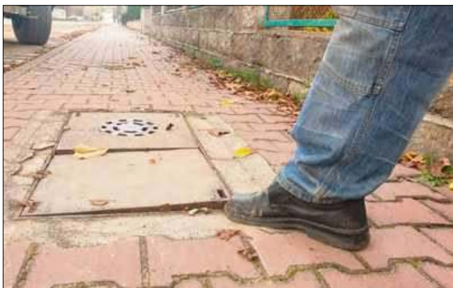
Wygląda to tak, jakby studzienka mogła się zarwać w każdej chwili.
