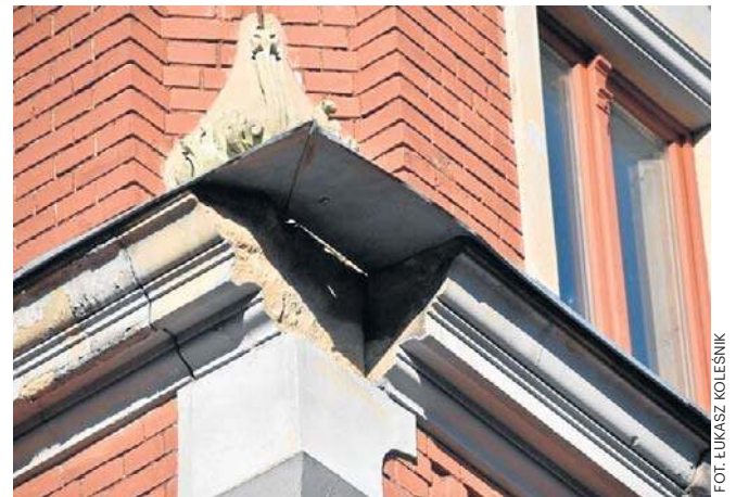
Miejsce pracy władz miasta jest wpisane do rejestru zabytków i wymaga remontu
