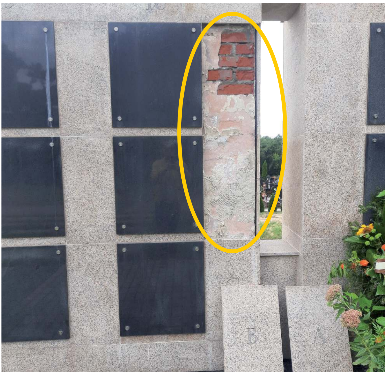
Choć nie wszystkie miejsca są zajęte w puławskim kolumbarium, to na zdjęciu możemy dostrzec, że budowa sypie się. Widać płyty, które wypadły ze ściany
