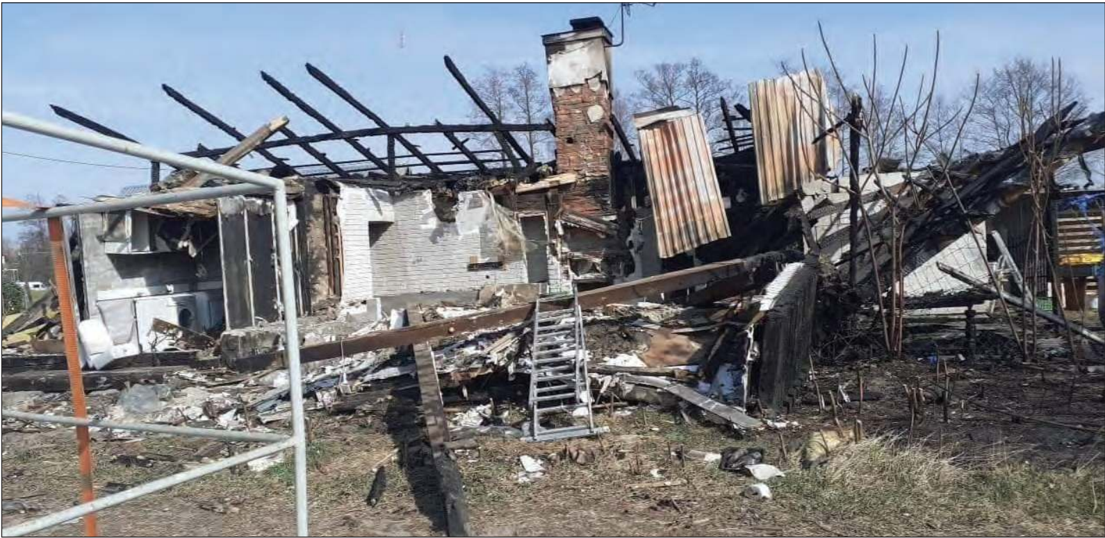
Budynek wymaga odbudowy elementów konstrukcyjnych - ścian, podłogi i dachu - a także wyposażenia go na nowo
