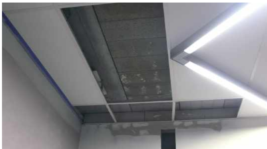
Na ścianach sal widać wiele pęknięć w ścianie, a w niektórych miejscach sufitu brakuje płytek
