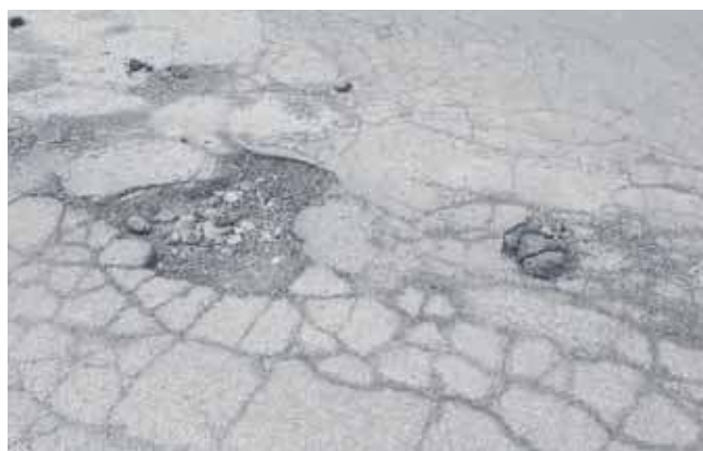
Ul. Górnicza przed łataniem dziur. Spękany asfalt, łaty i dziury w łatach
