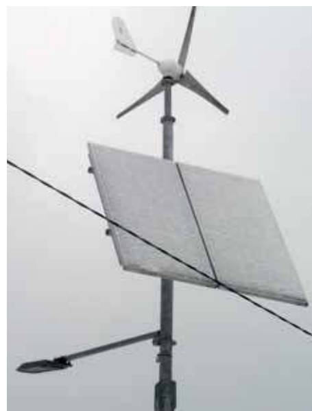
Latarnie przy obwodnicy w Strzegowie zasila prąd produkowany przez urządzenie hybrydowe
