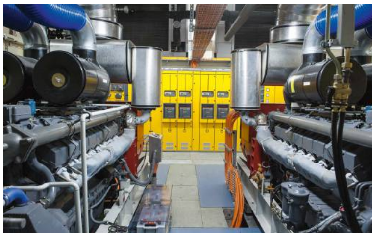
Zestaw generatorów Diesla w Swiss Fort Knox. Gwarantują ciągłość zasilania krytycznych systemów niezależnie od awarii zewnętrznej sieci.
