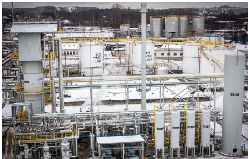
Wytwórnia wodoru. Trzebinia.
