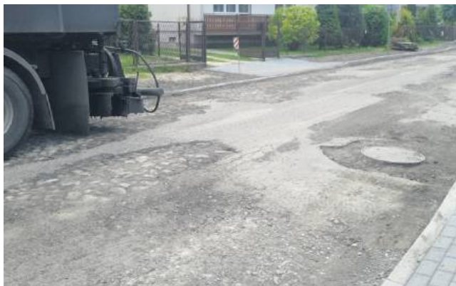
Wójt gminy twierdzi, że w budynkach znajdujących się w pobliżu drogi pękają ściany.
