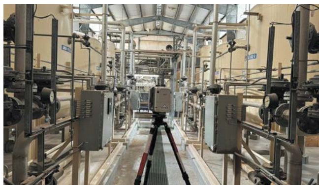
FOT. 2 Precyzyjne skanowanie laserowe 3D instalacji MEP w zakładzie przemysłowym umożliwia dokumentację przestrzenną, planowanie modernizacji i kontrolę bezpieczeństwa infrastruktury technicznej – APEX 3D Scanning Solutions; fot.: Creative Commons
