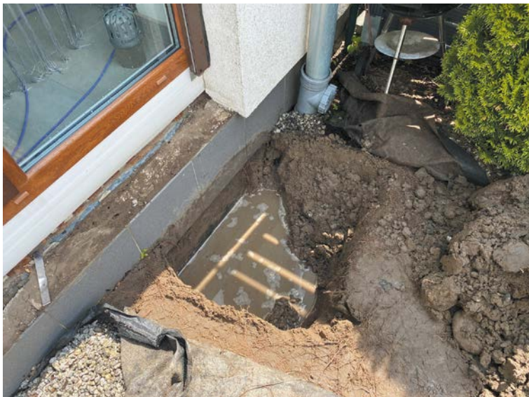
FOT. Woda stojąca w odkrywcę przy ścianie, na której zaprojektowano i wykonano izolację przeciwwilgociową, jednoznacznie wskazuje na popełnione błędy – z drugiej strony brak wody nie stanowiłby potwierdzenia, że błędów nie popełniono; fot.: autor
