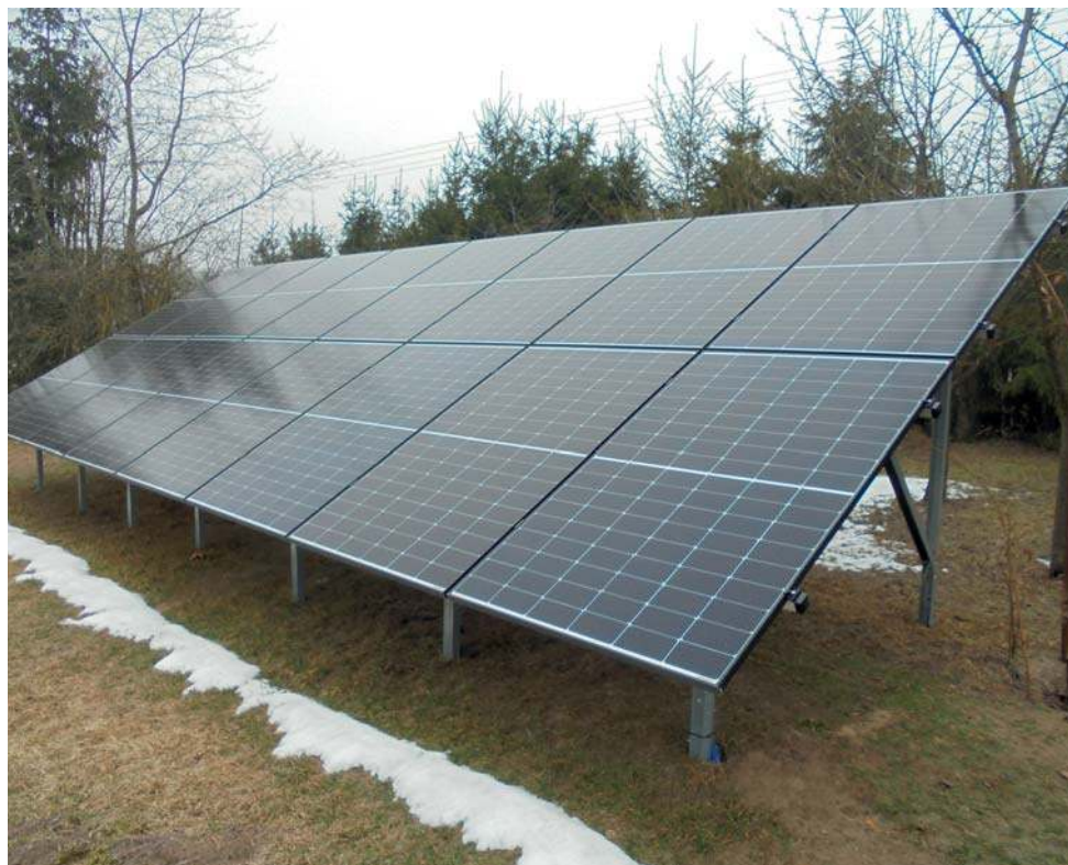
Panele fotowoltaiczne dofinansowane z Programu Czyste Powietrze
