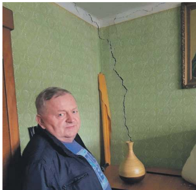
Splekana ściana w pokoju przedwojennego domu pana Stefana
