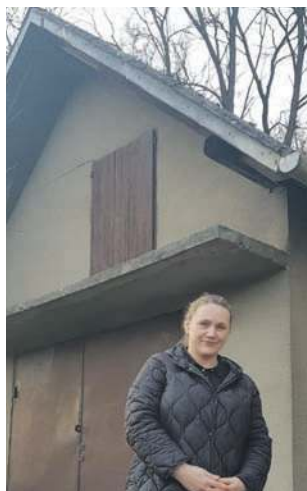
Aleksandra Matoga przed popękanym przy szczycie domkiem gospodarczym
