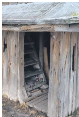
Dzwonnicy groziło zawalenie.
