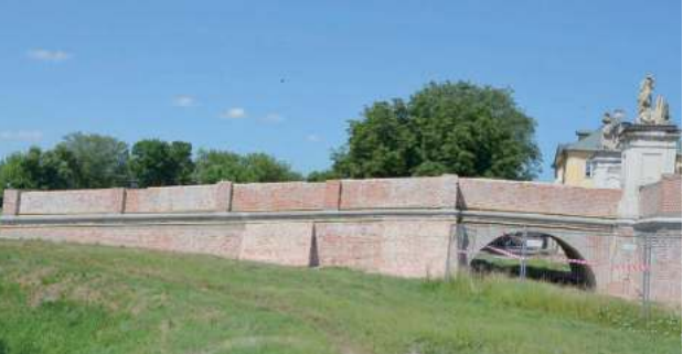
- Trzeba było rozebrać mur na zewnątrz celem jego podbudowy. Zanim to nastąpiło, trzeba było przeprowadzić uszczelnienie poprzez iniekcję, czyli wstrzykiwanie substancji, która zatrzymuje podciąganie wilgoci - tłumaczył na sesji burmistrz
