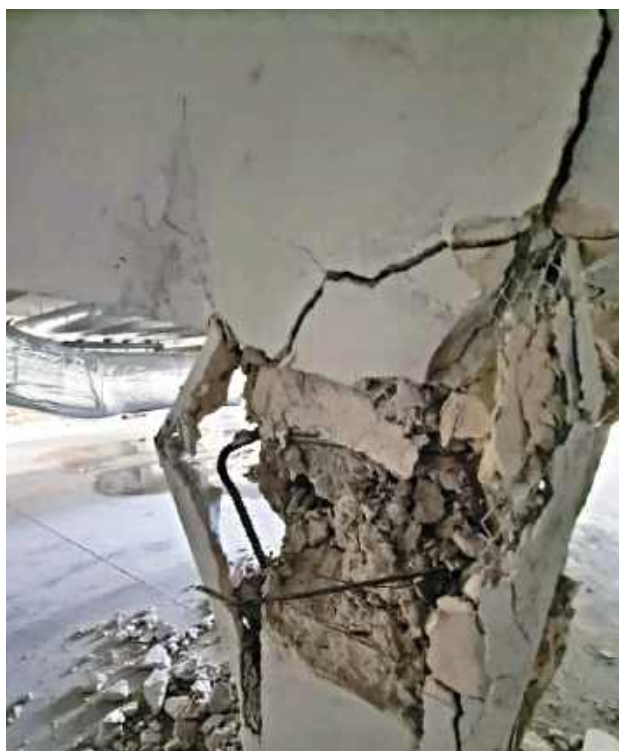
Pęknięcie słupa - specjaliści nie stwierdzili katastrofy budowlanej
