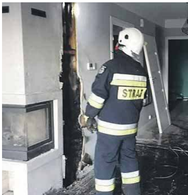
Pożar w Żygli. Prawdopodobnie zaczął się od kominka, a przyczyną mogła być niewłaściwa izolacja
