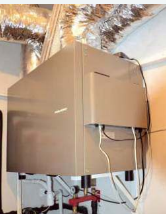
➤ Przeciwprądową centralę wentylacyjną zainstalowano w kotłowni.
