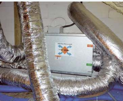
🔗 Centrala wentylacyjna znajduje się na ocieplonym nieużytkowym strychu.
