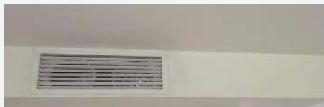
📍 Kratka nawiewna instalacji z kanałową jednostką.
