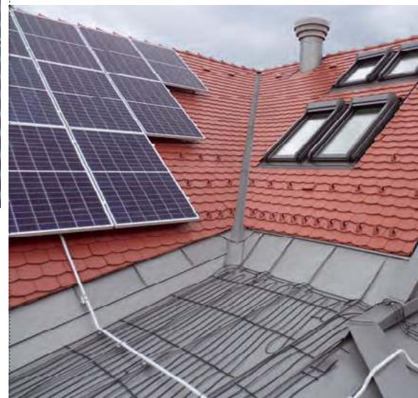
☛ Typowa instalacja fotowoltaiczna zajmuje 20–40 m 2 powierzchni. CREATON POLSKA
