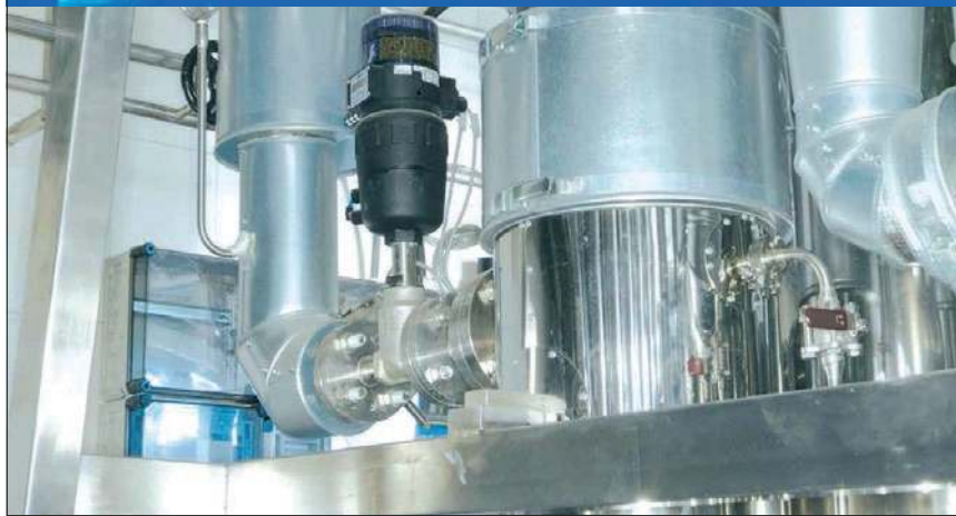
Fot. 1. Zawór bez izolacji – w obrazie termograficznym dobrze widoczne miejsca strat ciepła [2]
