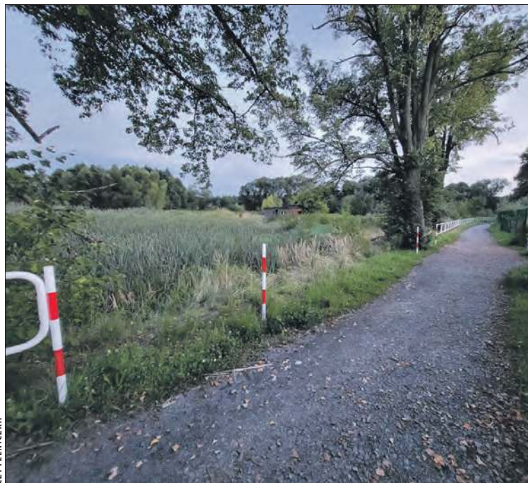
Jeden z fragmentów ogrodzenia ścieżki z brakującymi barierkami
