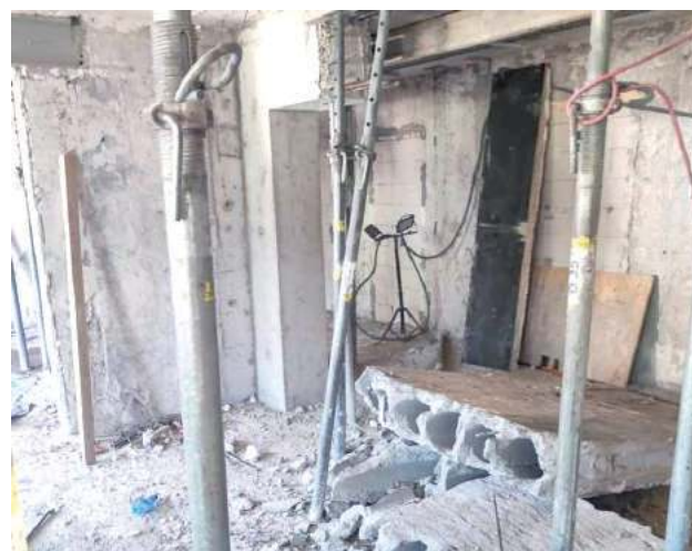
Wstępne czynności wskazują, że 17-latek został przygnieciony przez ścianę w trakcie próby wyburzania - informowali policjanci
