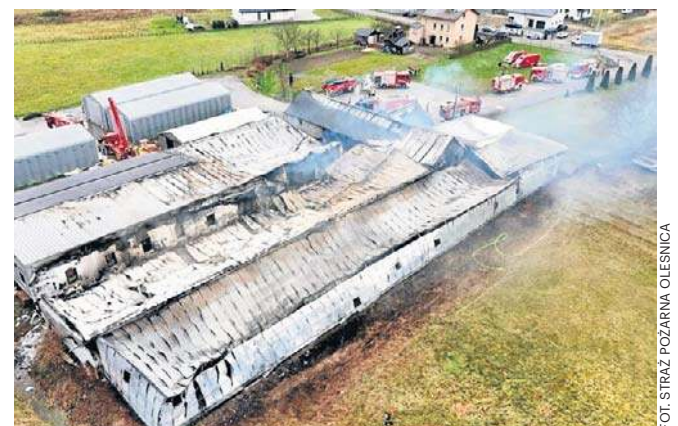
Pożar w Komorowie wybuchł rok temu. Powodem było niekorzystne zjawisko termalne, związane z przepływem prądu
