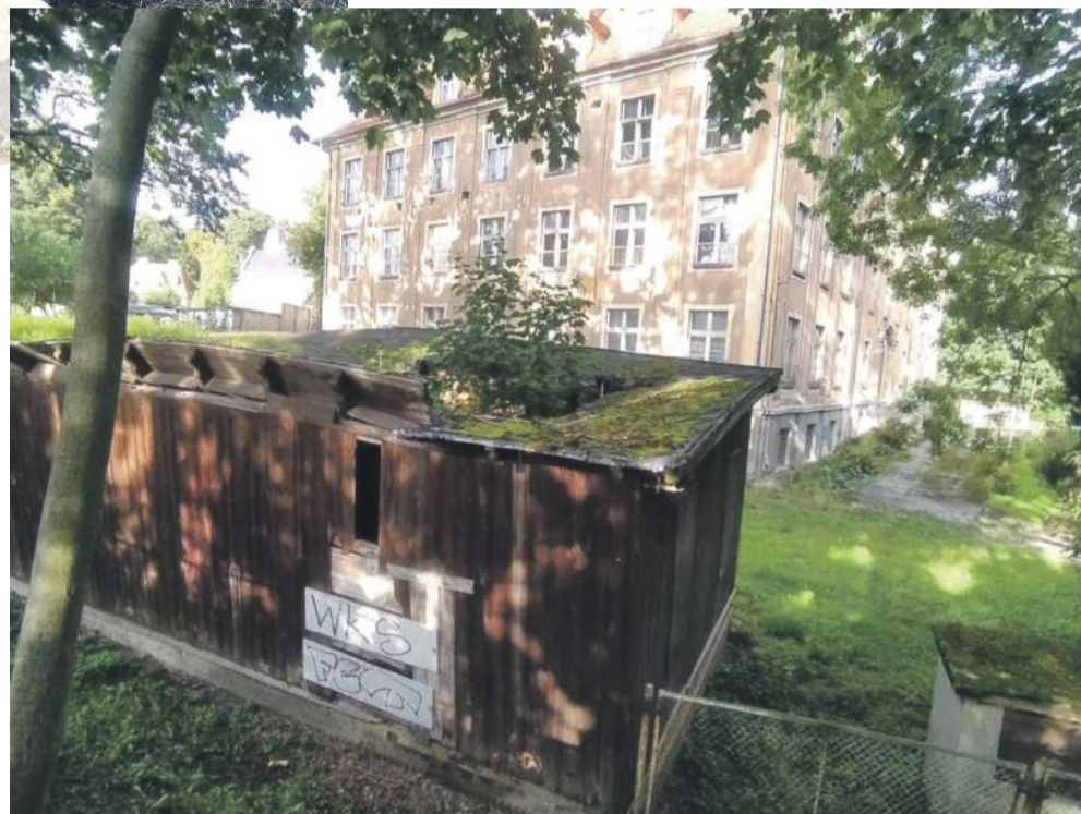
Przez dach widać wyrastające drzewa
