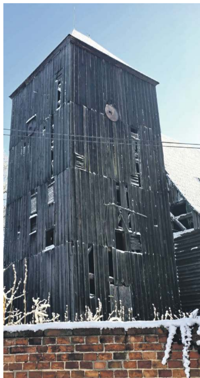
Dziury w wieży
