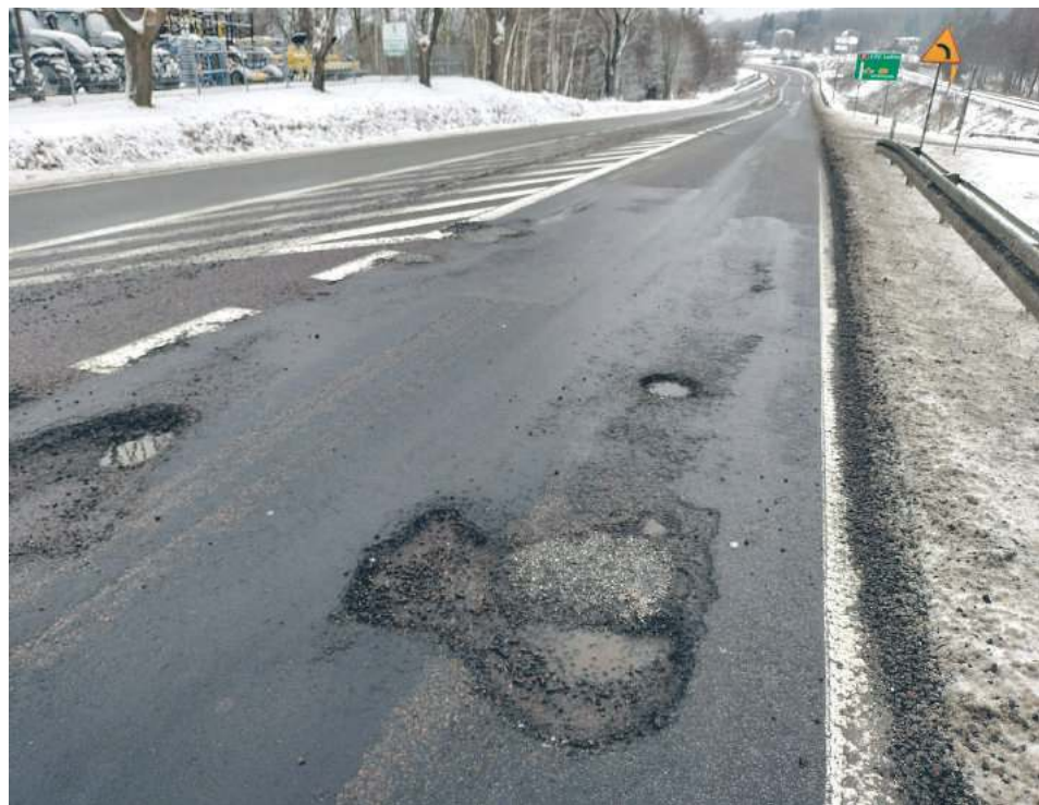
Dziury na DK17 na odcinku Krasnystaw – Izbica
