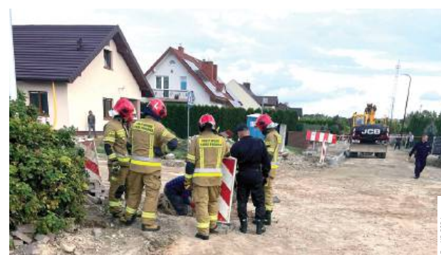
16 września, rozszczelnił się rurociąg gazowy na ul. Różanej w Łęcznej
