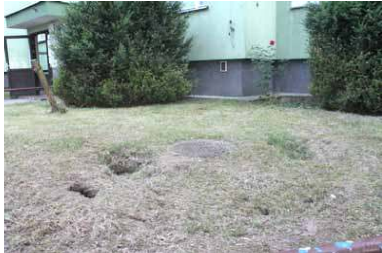
Jak widać teren trawnika został zaatakowany przez drążące tunele szczury
