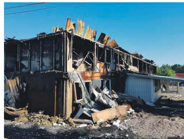
Budynek hotelu nie nadaje się już do zamieszkania
