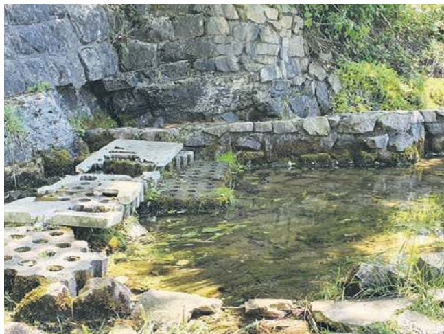
Dojście do źródła w Regulicach czeka na wymianę płyt
