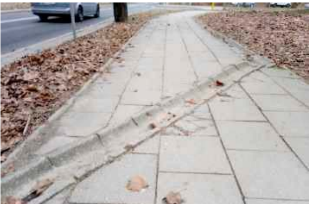
Na chodniku przy ul. Kosmowskiej, za skrzyżowaniem z ul. Kiepury na pieszych czyha pułapka - głęboki odpływ dla deszczówki w poprzek przecinający przejście
