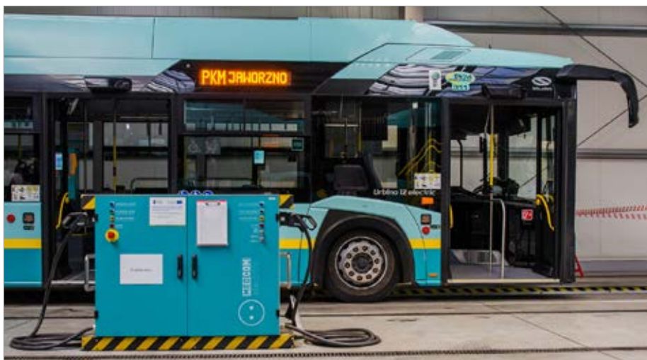
Stacja ładowania autobusów elektrycznych firmy Medcom w Jaworznie fot. PKM Jaworzno
