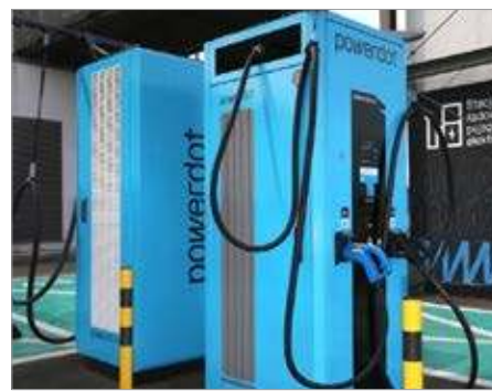
Stacja ładowania na parkingu Galerii Krakowskiej fot. Powerdot
