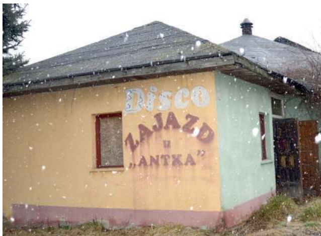
Dach budynku w części spłonął. Wnętrze od lat nie służyło jako restauracja, tylko warsztat samochodowy.
