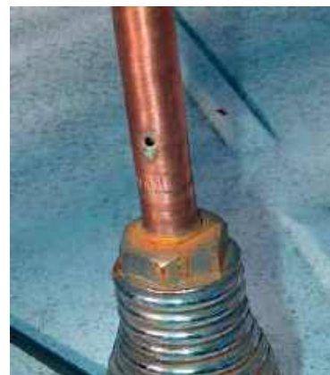
Mocowanie anteny na sprężynie. Otwór w rurce zapewnia odpływ gromadzącej się wody
