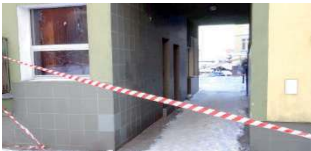
Spółdzielnia Mieszkaniowa „Skarbek” zagroziła w ubiegłym tygodniu tunelowe przejście w bloku przy Obrońców Pokoju 5. Część mieszkańców jednak nadal z niego korzystała nie zważając na wiszące nad głowami ciężkie sope
